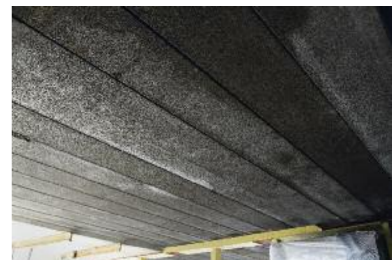
Elementene er ferdig tilpasset på fabrikk. På byggeplass utføres fugestøp, poreetting og vanlig avretting.
