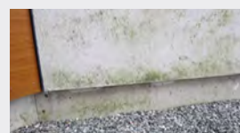
Sokkel som er angrepet av alger.
