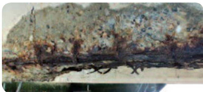
Kjemisk skade. Armeringskorrosjon
