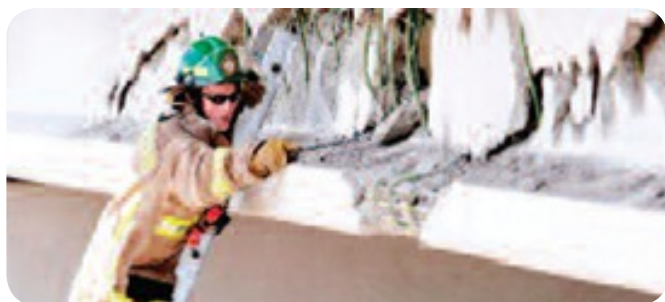
Mekanisk skade. Skade fra sammenstøt, ytre påkjenning
