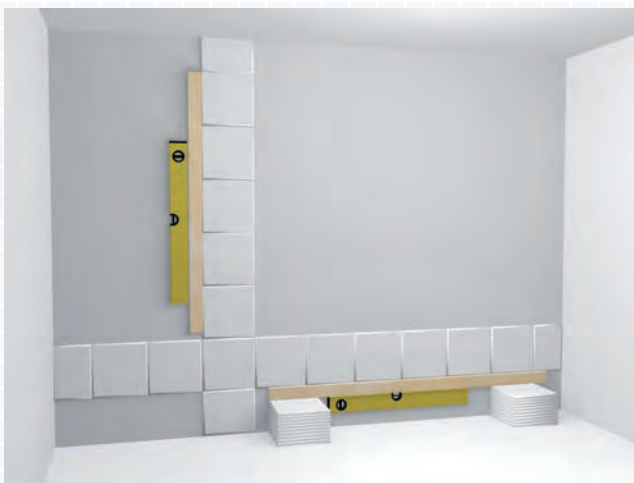
Figur E.9.1 Flislegging på vegg.
